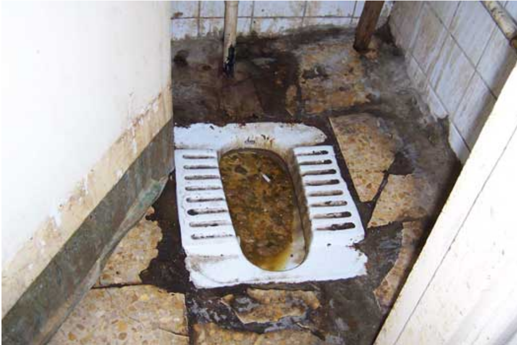
Beaucoup d'hôpitaux étudiés à Bagdad n'ont pas les moyens d'engager une femme de ménage. Ceci est une toilette dans le service des soins intensifs à l'hôpital Al-Kerkh à Bagdad.
